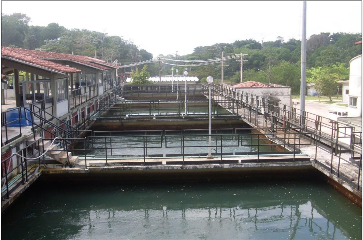
Figura 13 – Instalações da ETA Bolonha.
